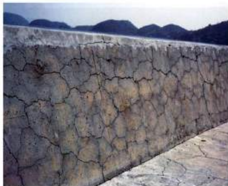
アルカリシリカ反応によるひび割れ
